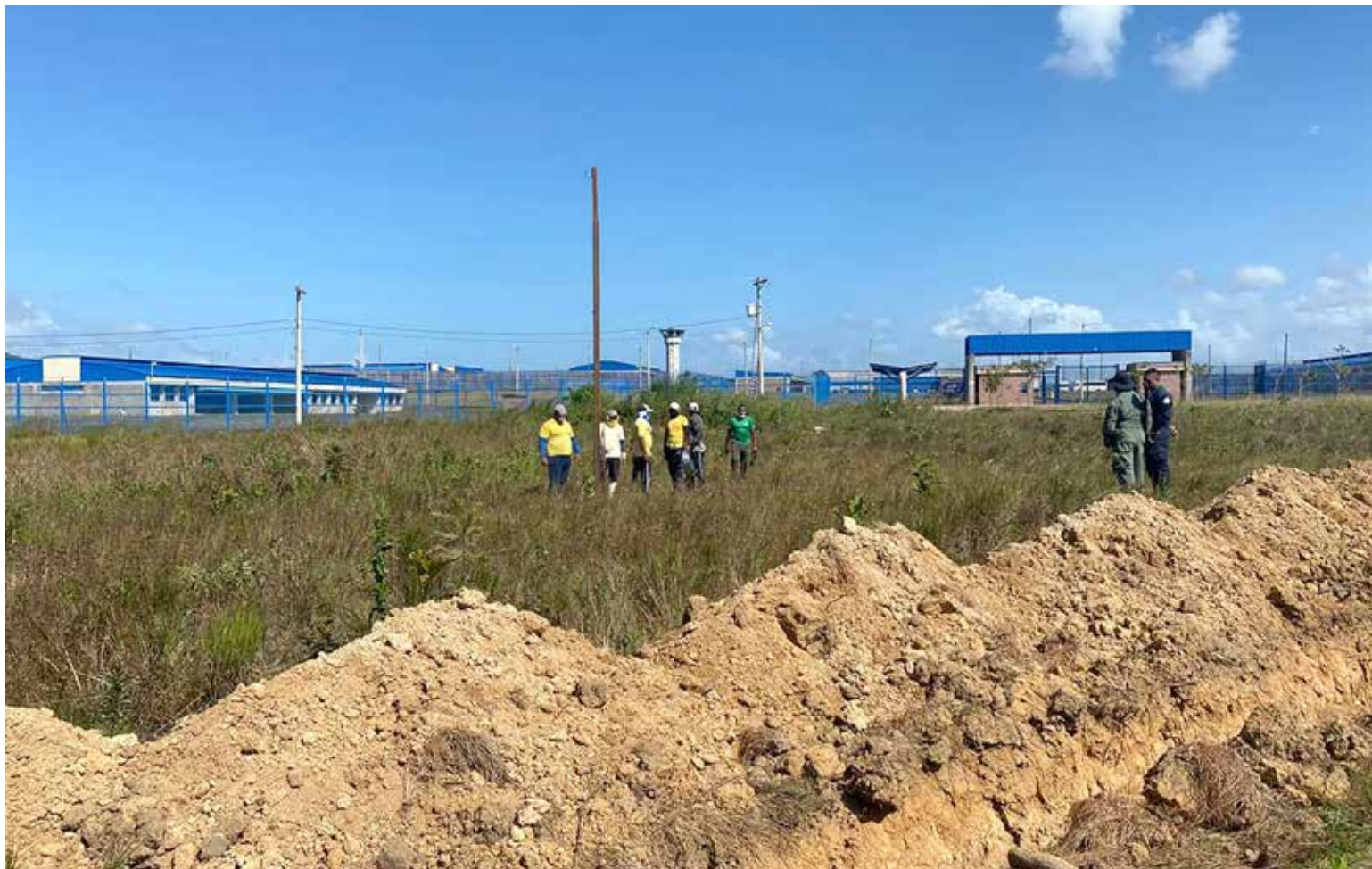
Soterramiento de líneas de conducción para los pozos de agua del centro penitenciario.
