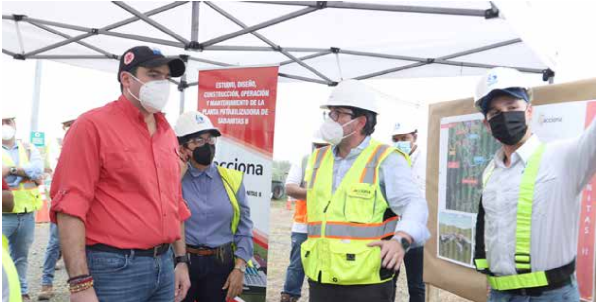
El vicepresidente de la República, José Gabriel Carrizo Jaén, recorre la construcción de la nueva Planta Potabilizadora de Sabanitas, que tiene un 45% de avance, y que beneficiará a 115 mil habitantes de 12 corregimientos de la provincia de Colón.
