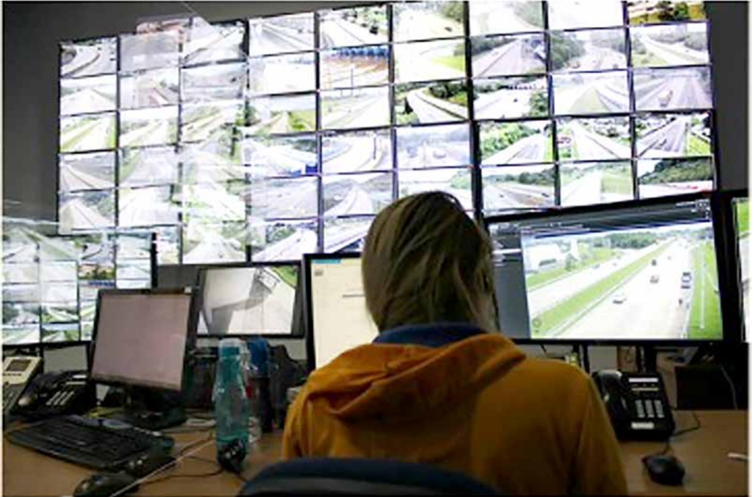
Equipo de monitoreo de las autopistas.
