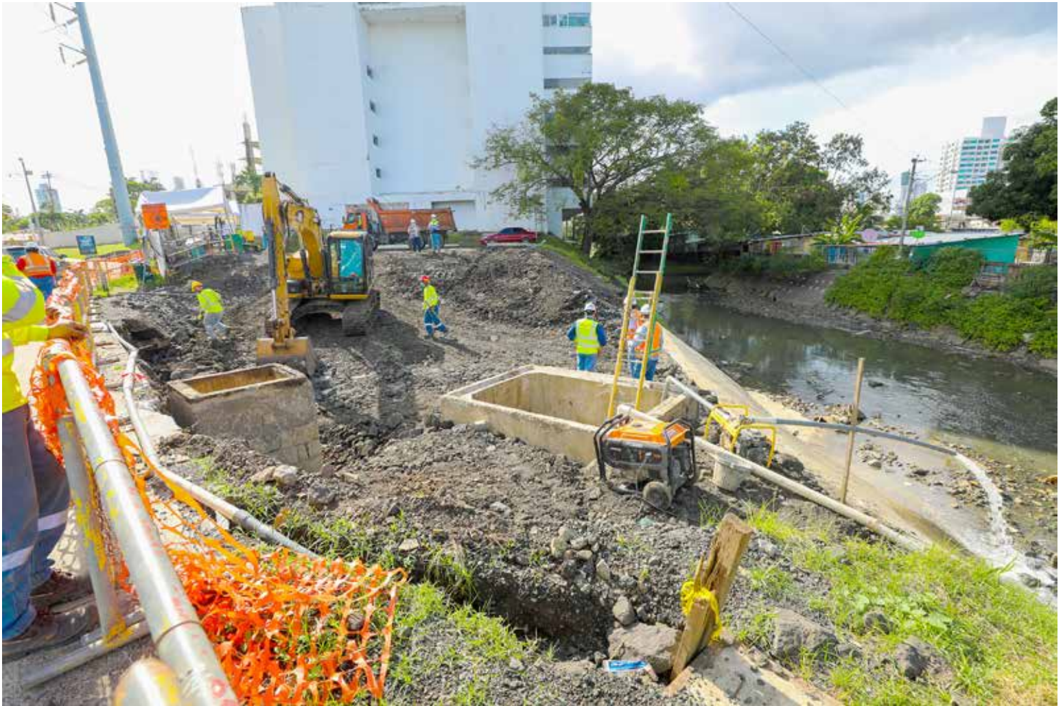
Los trabajos ejecutados por el Programa Saneamiento de Panamá, a través del contratista M2 Consorcio, están por culminar.
